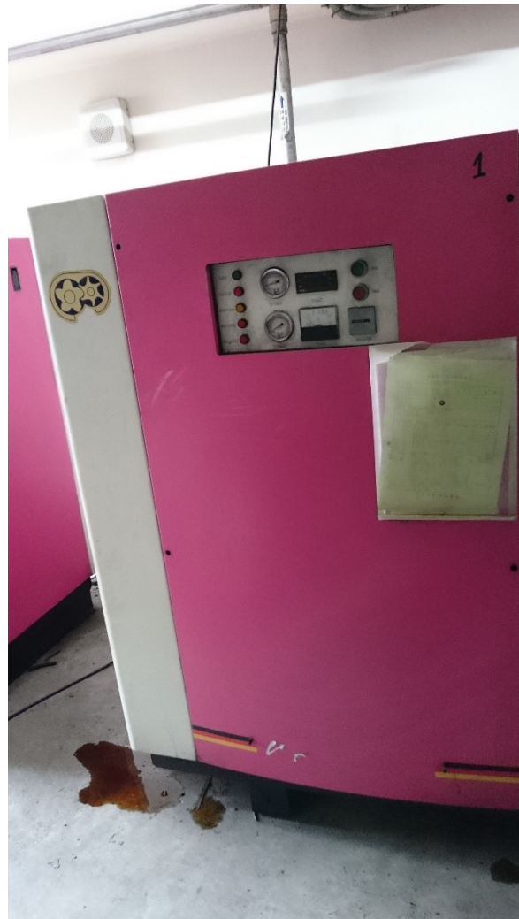
空壓機漏油狀況
